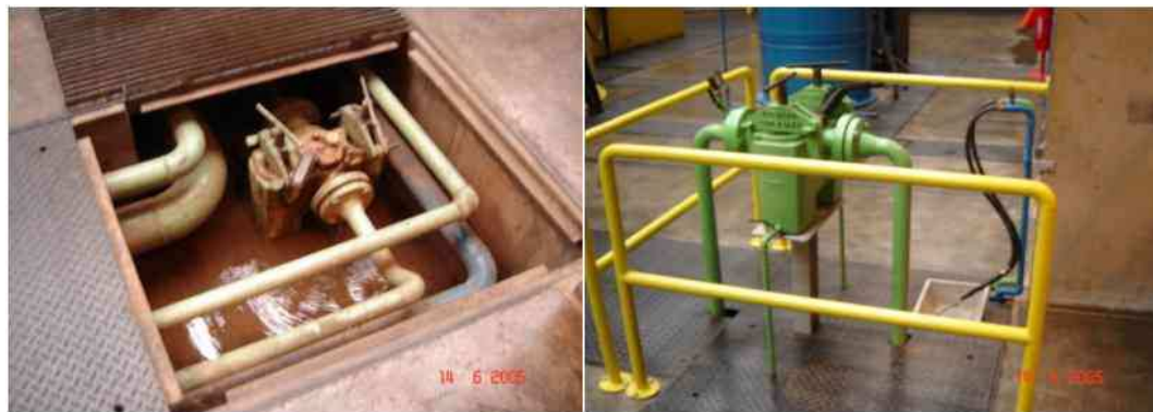
Fig. 3 – Modificações em filtros facilitando limpeza e manutenção
