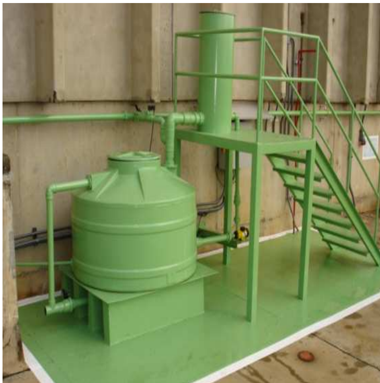
Fig. 4 - Unidade de preparação de cloro
