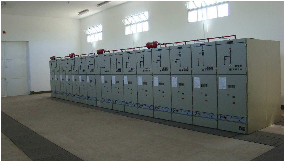
Fig. 1. Tablero de Celdas de 13,2 kV
