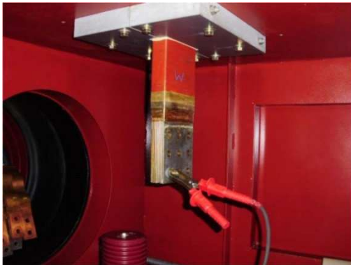
Fig. 7 - Ensayo Surge a generador 280MVA
