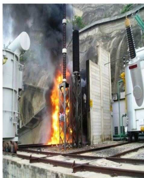
Fig. 3 – Incêndio no transformador elevador de Paulo Afonso III.
