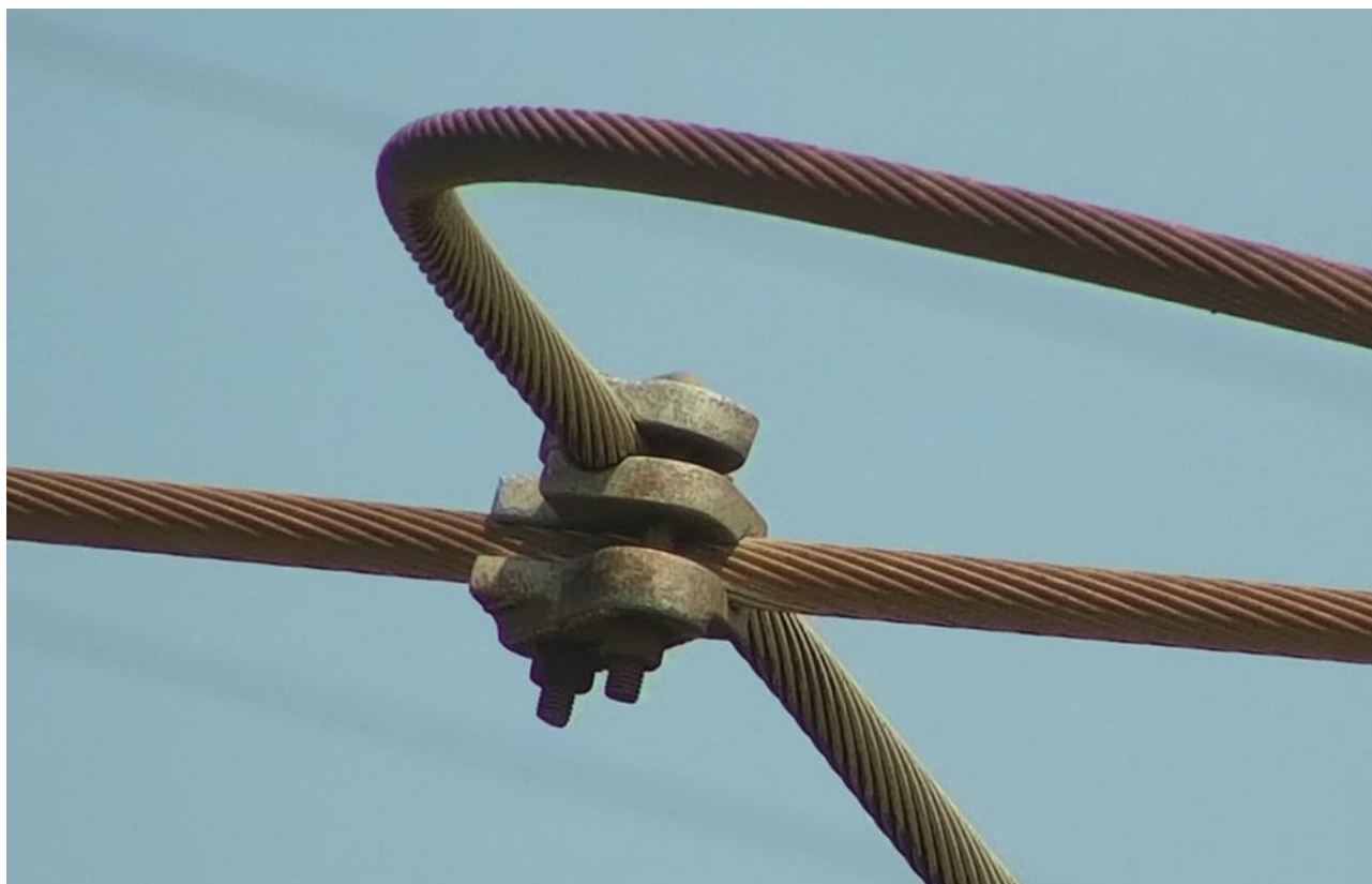
Figura 2: Conexão de interligação dos cabos para-raios
