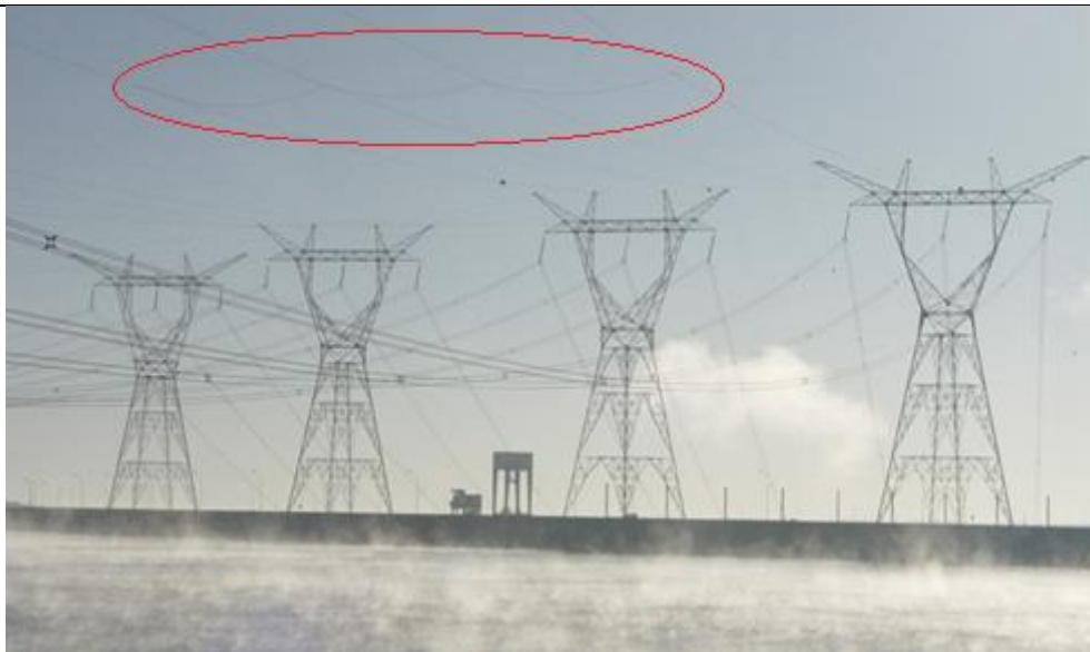
Figura 3: Imagem da interligação dos cabos para-raios
