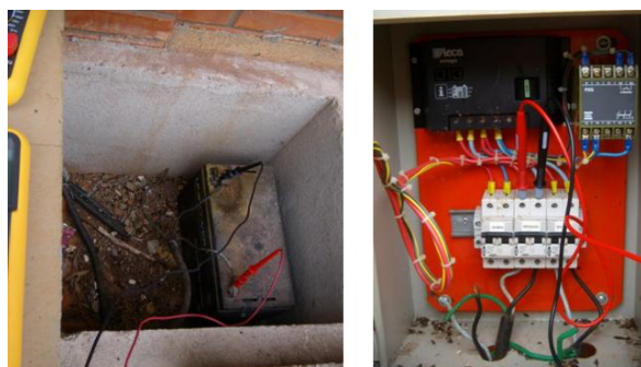
Figura 2: Bateria e painel de controle do aerogerador Air-X instalado no Refúgio Biológico.
