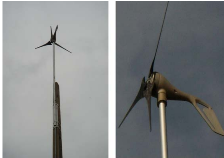
Figura 3:Aerogerador instalado no Refúgio Biológico.
