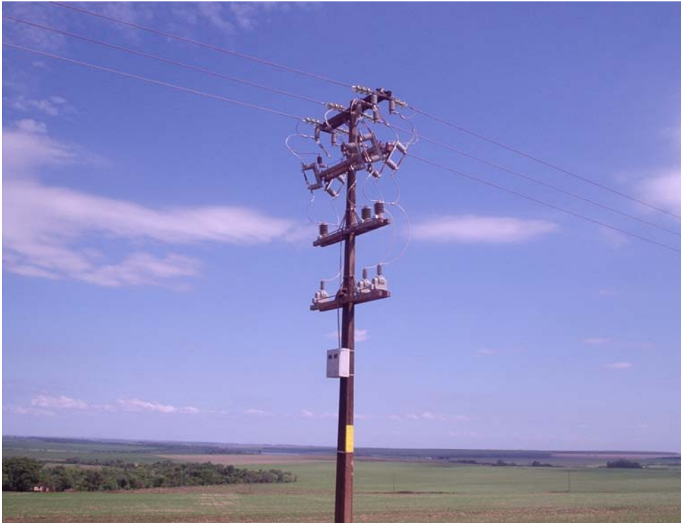
Figura 4 : Medidor Totalizador instalado en la entrada de Colonia de Santa Fe
