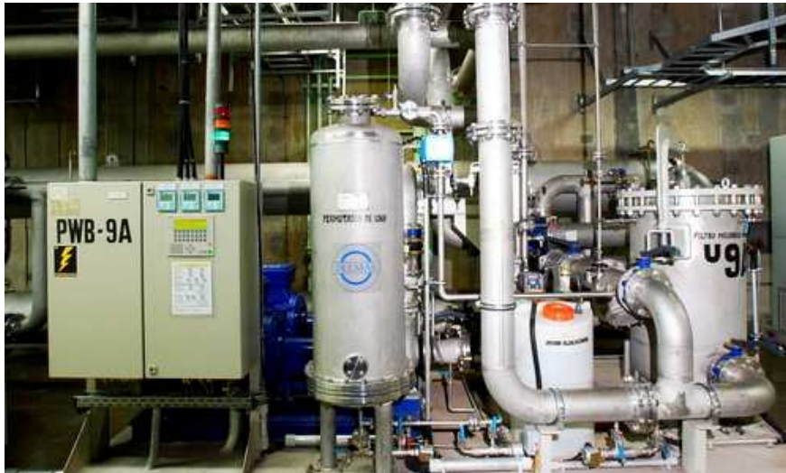
Figura 10 – Sistema de Água Pura das Unidades Geradoras 9A e 18 A
