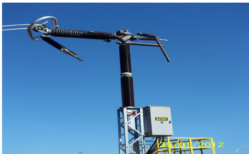
Figura 7 – Foto da fase R do disjuntor 84T05 após explosão.
