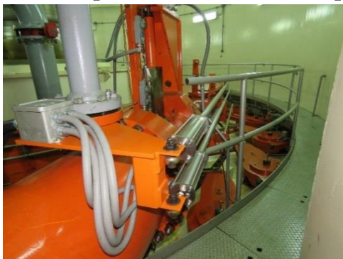
Figura 9. Transductor lineal de posición de paletas del distribuidor.
