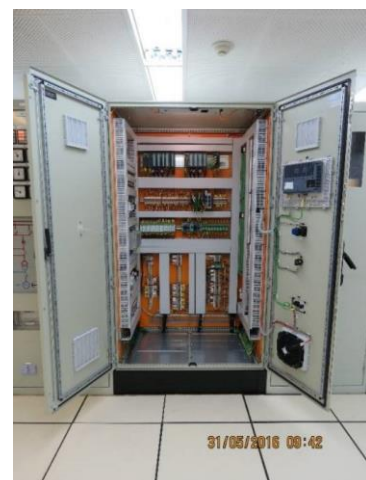
Figura 3. Tablero VGC abierto.
