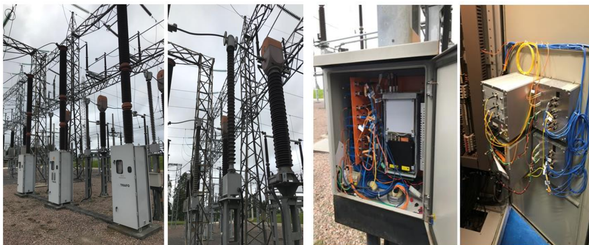
Figura 5: Vista del TC Óptico (izquierda) y su tablero de conexionado en el patio de la Subestación Uberaba 230 kV (derecha) [7]
