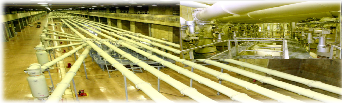
Figura 1: Vista general de la Subestación Blindada y Aislada a Gas SF 6 (GIS) de Itaipu
