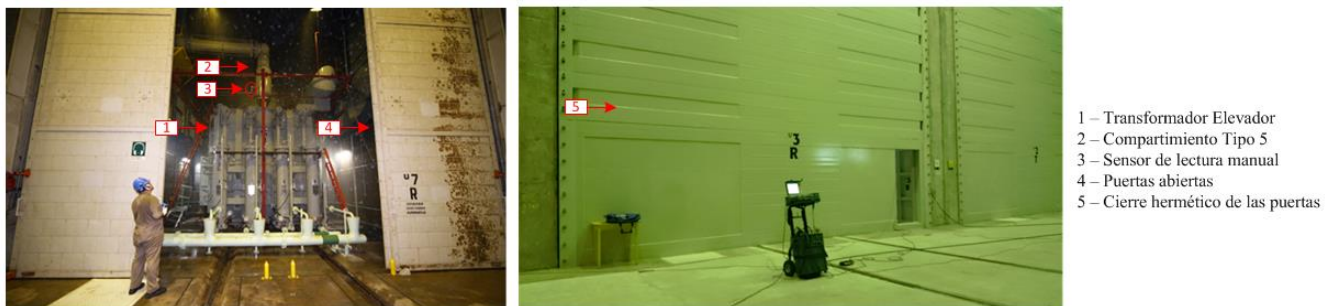
Figura 2.1: Antes y después del cierre hermético de los transformadores elevadores
