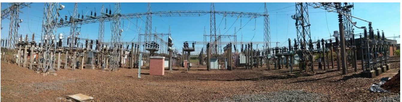
Figura 3: SEMD - Patio 66kV, Posición Nueva Celda para T08
