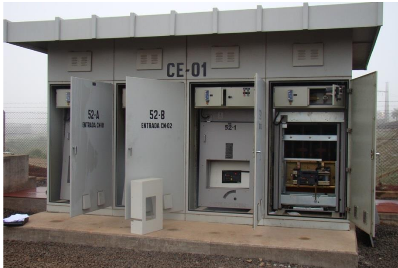
Figura 2: Centro de Distribución CE-01 23kV
