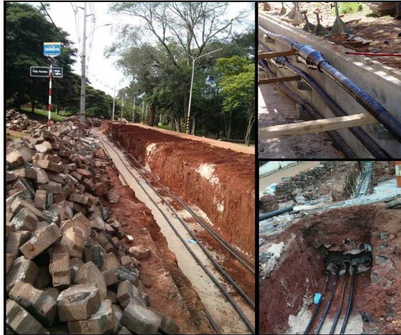
Figura 3. Tendido y empalmes de conductores subterráneos de la doble terna LT 66kV SEMC-APR.
