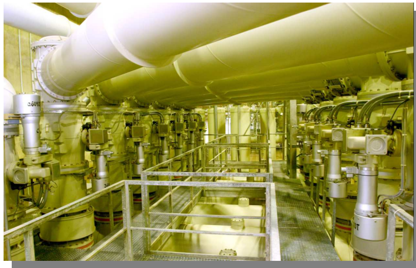
Figura 1: Vano típico de unidades generadoras de la GIS
