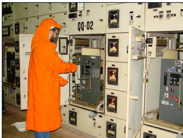
Figura 3: EPC que atenúa y evita accidentes.
