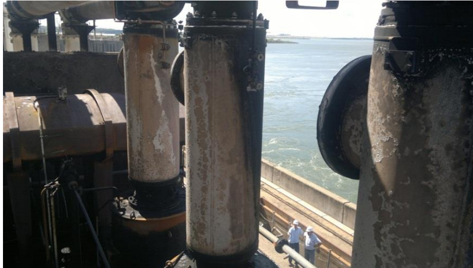
Imagen 4 - Daños Barras Aisladas.
