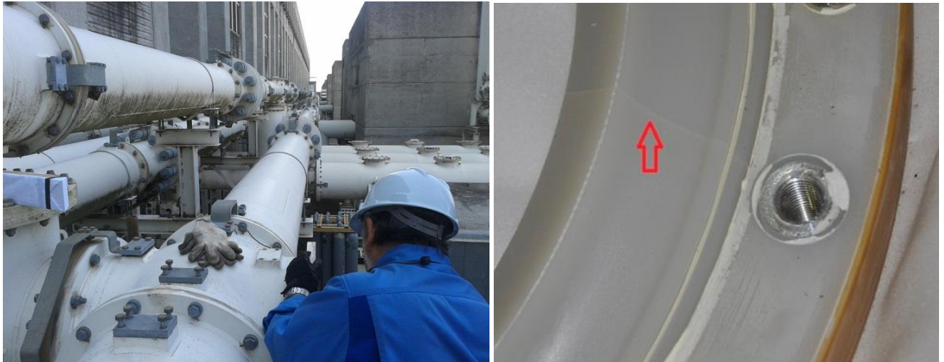
Imágenes 13 y 14 – Inicio desmontaje tramo barras W22 y fisura en espaciador de tramo con fuga.
