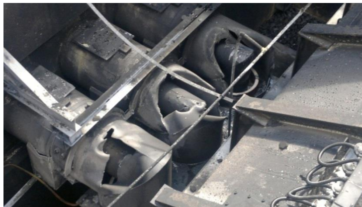
Imagen 5 – Daños en barras 13.2 kV.
