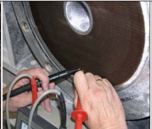
Foto 2: RIP-Verificación de camadas en corto
