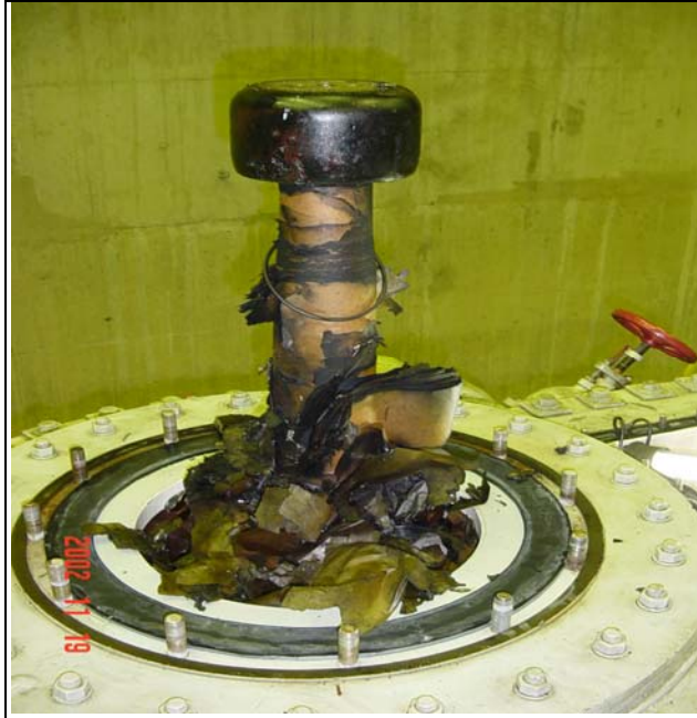
Foto 3: OIP - Lado gas SF6
