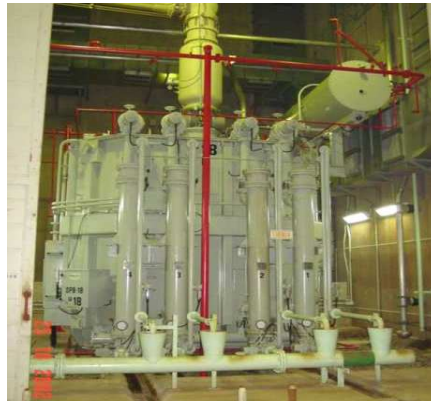
Figura 3: Transformador Principal de la Unidad
