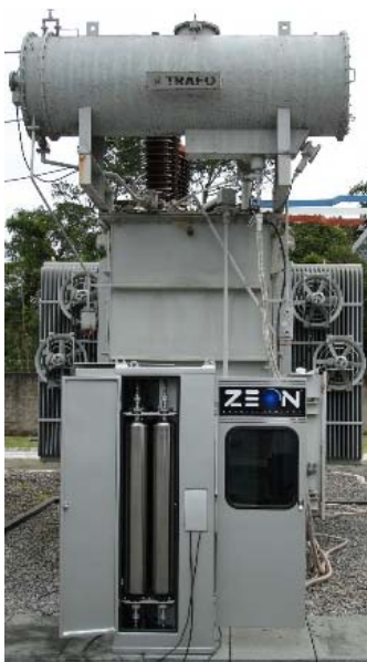
Figura 1: Sistema de secagem instalado em transformador de potência energizado
