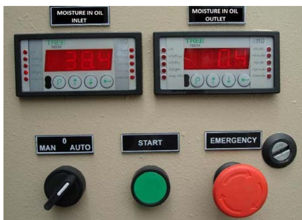
Figura 2: Vista dos sensores do sistema de secagem e do painel de controle
