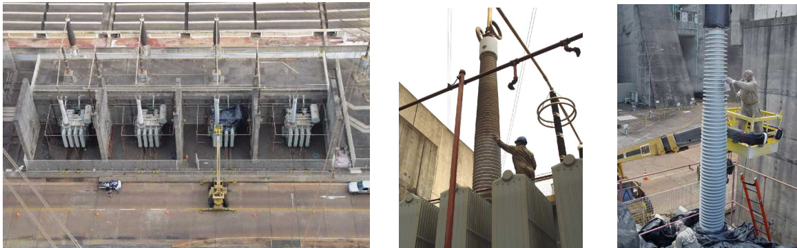
Figura 6 – Aplicação do RTV sobre as buchas dos transformadores de 60 Hz em maio de 2008.
