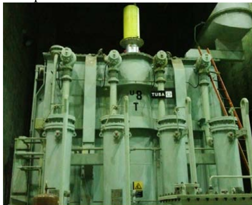
Figura 6: Transformador de Potencia monofásico de 275 MVA.
