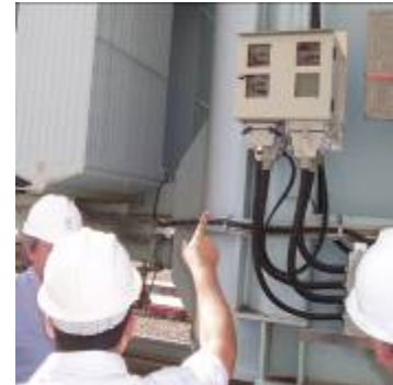
Figura 1 – IEDs en un transformador de potencia
