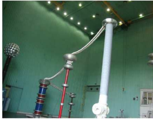
Figura 3: Conexión de equipos de test
