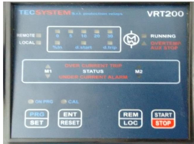
Figura 4. Control Funcionamiento Ventiladores (VRT 200).
