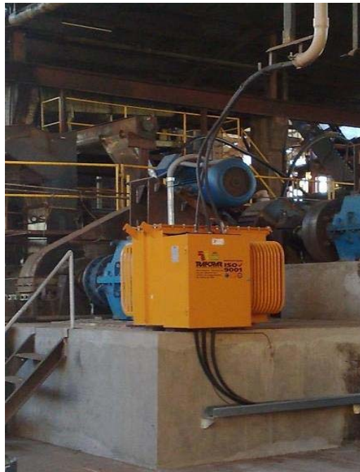
Fig. 7 Vista General Transformador-Compensador
