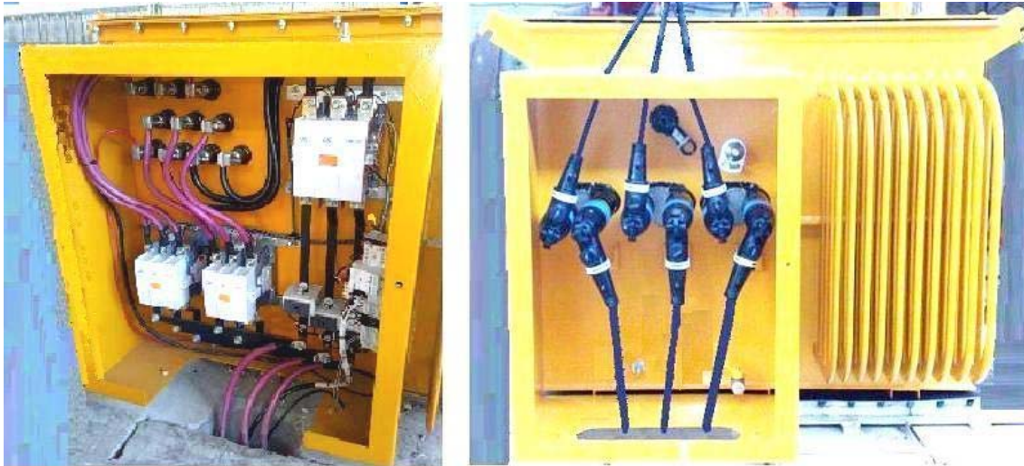
Fig. 6 Lados de BT y MT del Transformador-Compensador
