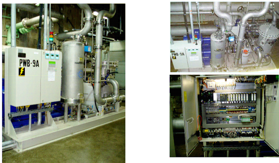
Figura 13 – Sistema de Supervisão e Controle (novas unidades)
