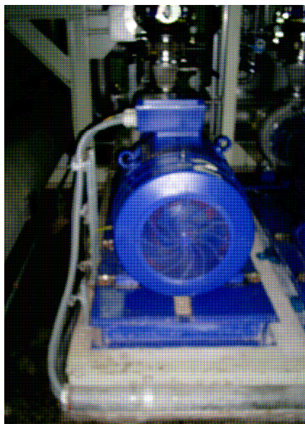
Figura 16 – Condutores Flexíveis para Alimentação dos Motores
