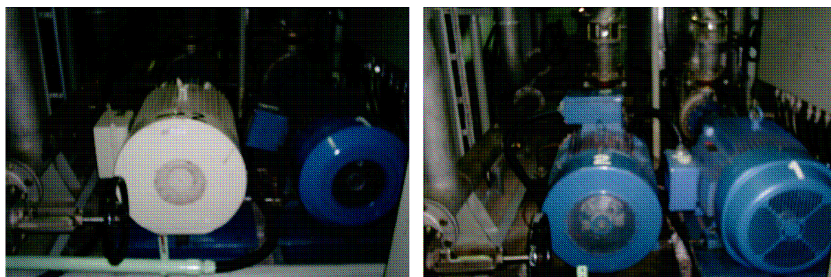
Figura 14 – Caixa de Conexão dos Motores
