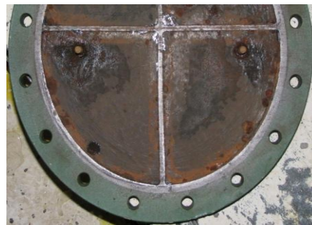
Fig. 28 – TC Turbina/ UG08 (con ozono)
