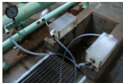
Fig. 11 – Instalación de Bio-boxes Ozonizada
