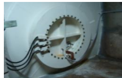
Fig. 12 – Captación del Agua Bruta
