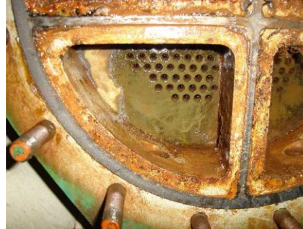
Fig. 26 – TC Turbina/ UG08 (con ozono)
