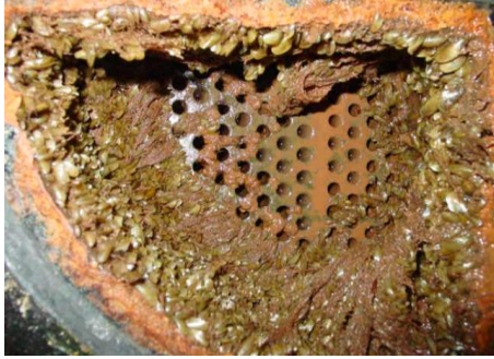
Fig. 25 – TC Turbina/ UG06 (sin ozono) ozono)
