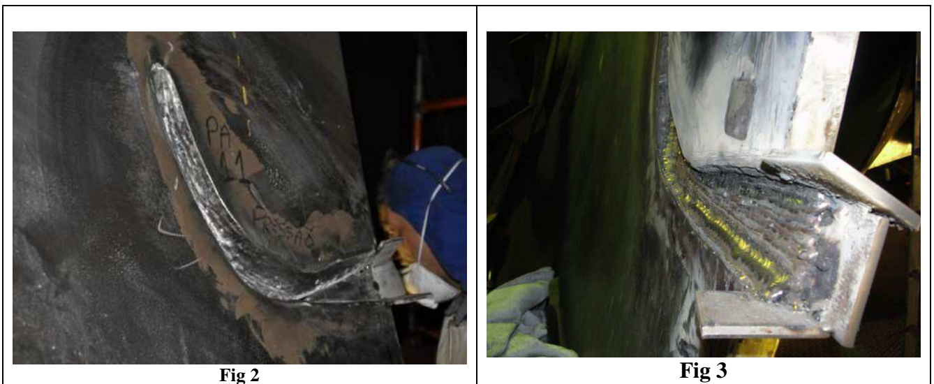
Fig.2 – Remoción de la fisura lado presión - Fig 3 – Depósito parcial de soldadura lado presión del álabe N11
