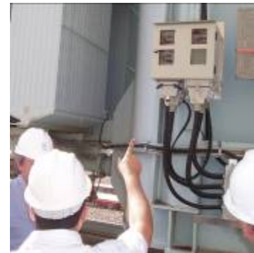
Figura 1 – IEDs en un transformador de potencia
