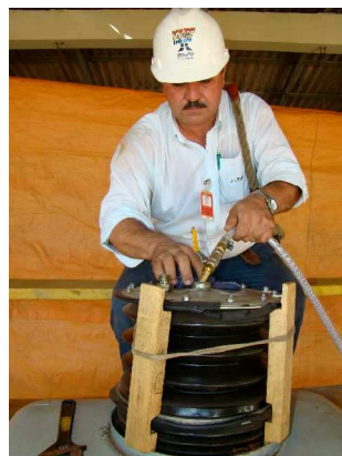
Figura 7 – Enchimento de óleo
