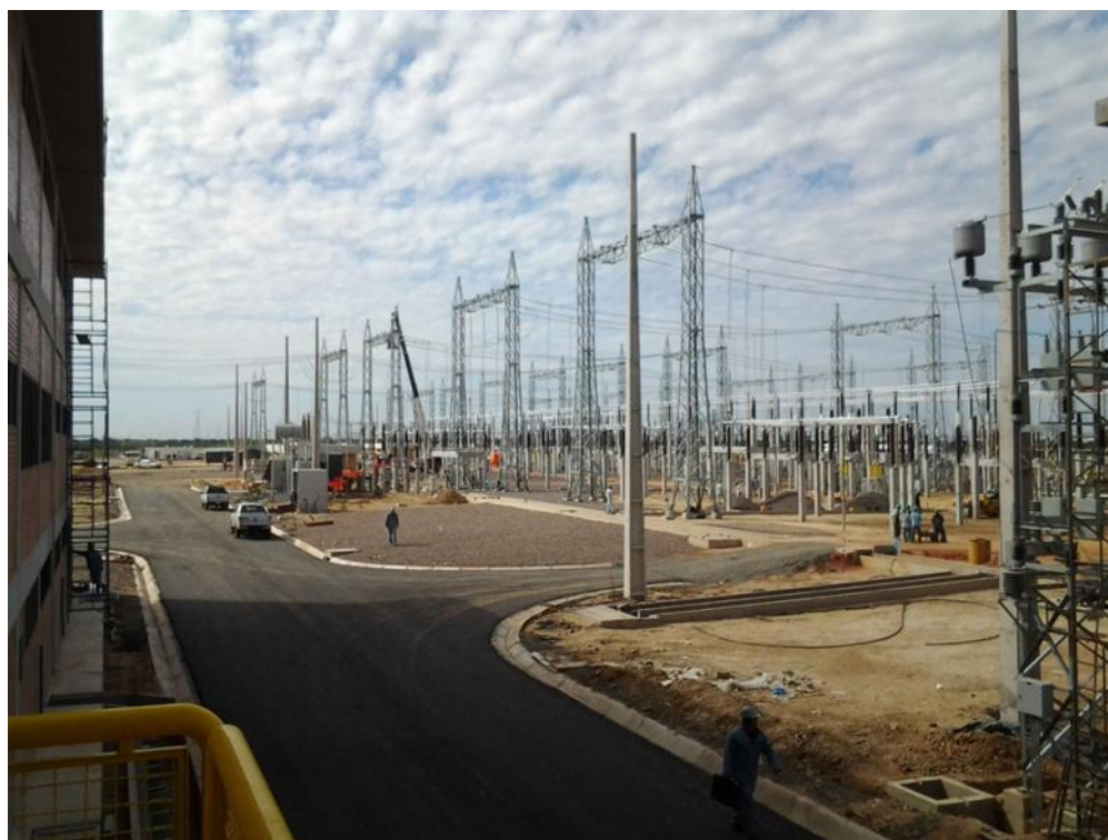
Subestación Villa Hayes
